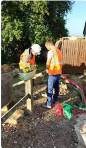
C'est un chantier d'envergure qui se déroule en ce moment dans le village.
